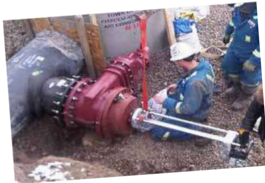
Kanada - 28"x18" IPS EF Seme Canlı Hat Bağlantısı Canada - 28"x18" IPS EF Saddle Hot Tapping Application
