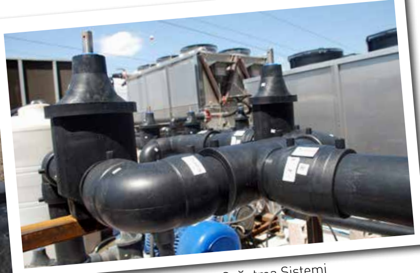
Türkiye - Soğutma Sistemi Turkey - Cooling System
